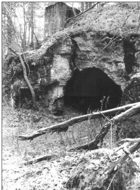
Рис. 5. Крепость Осовец. Форт № IV (Новый), разрушенная казарма. Современное состояние
